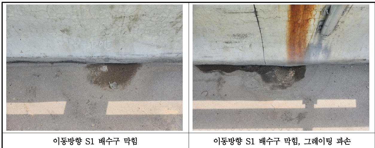
【사진 1.3.20】 배수시설 손상현황
