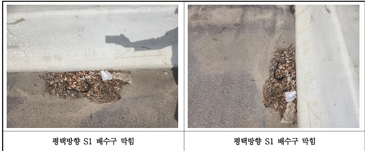
【사진 1.3.20】 배수시설 손상현황(계속)
